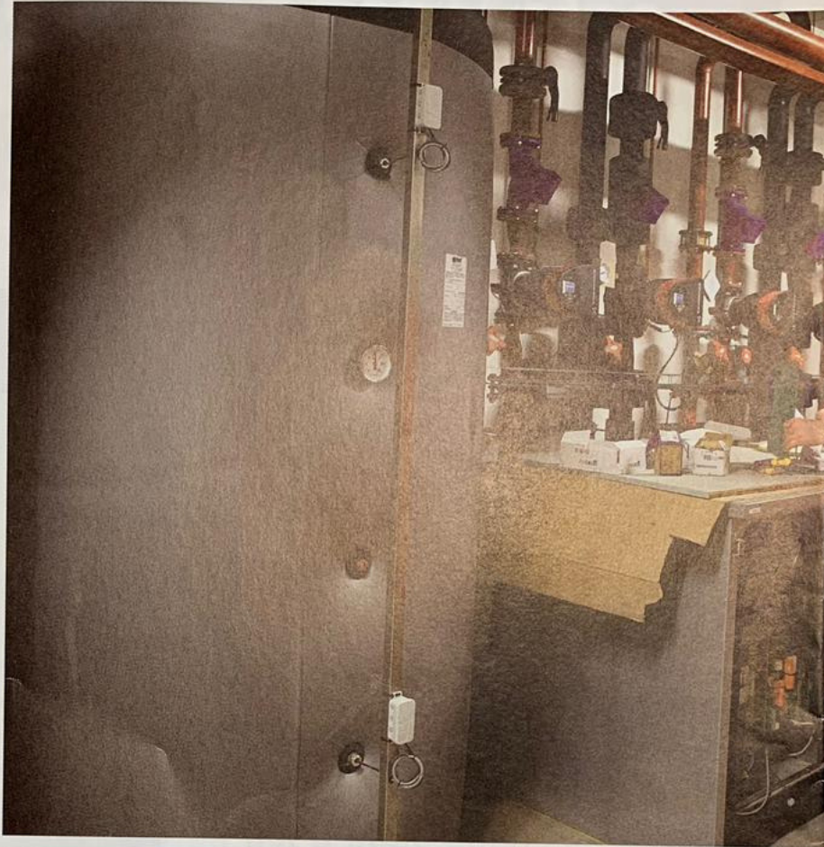
△ Technische ruimte bij Van Raam. In het midden de twee Alpha Innotec-warmtepompen, met aan weerszijden de 1500
